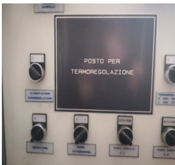
Figura 4.5 - Particolare del pannello di controllo di dell'impianto termico
