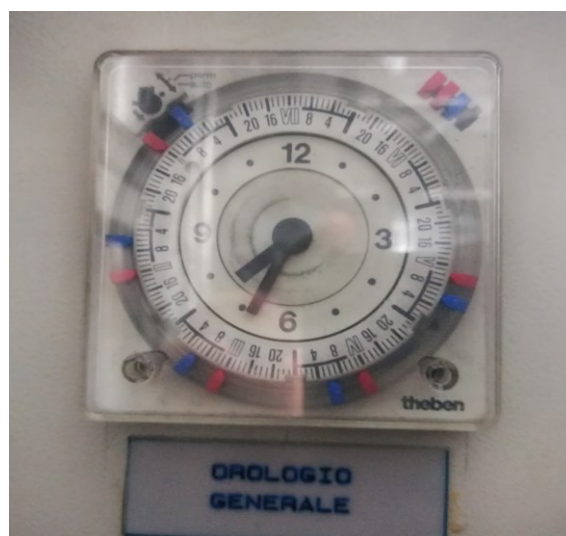
Figura 4.6 – Orologio generale a servizio dell'impianto termico
