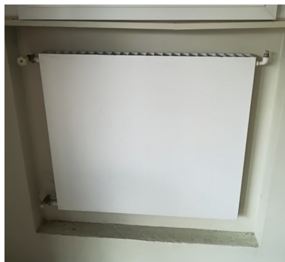
Figura 4.4 - Particolare dei radiatori installati sulle pareti esterne degli ambienti
