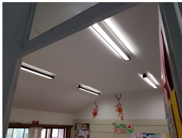
Figura 4.12 - Particolare dei corpi illuminanti ubicati
