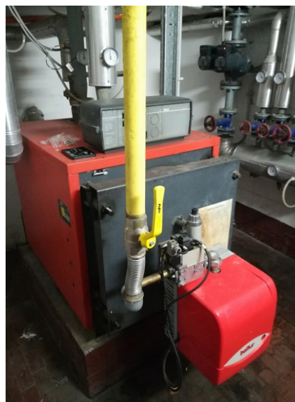
Figura 8.9 - Particolare del generatore di calore attuale
